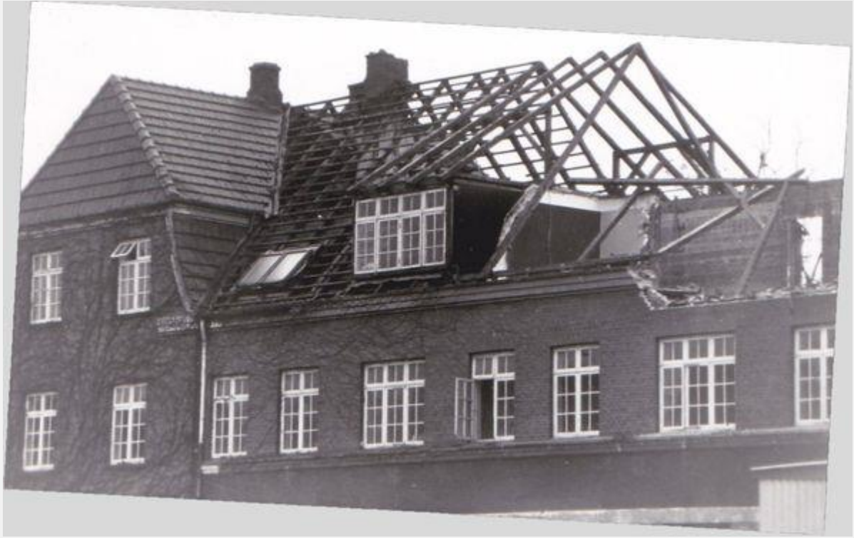
Brugsforeningen under nedbrydning.
